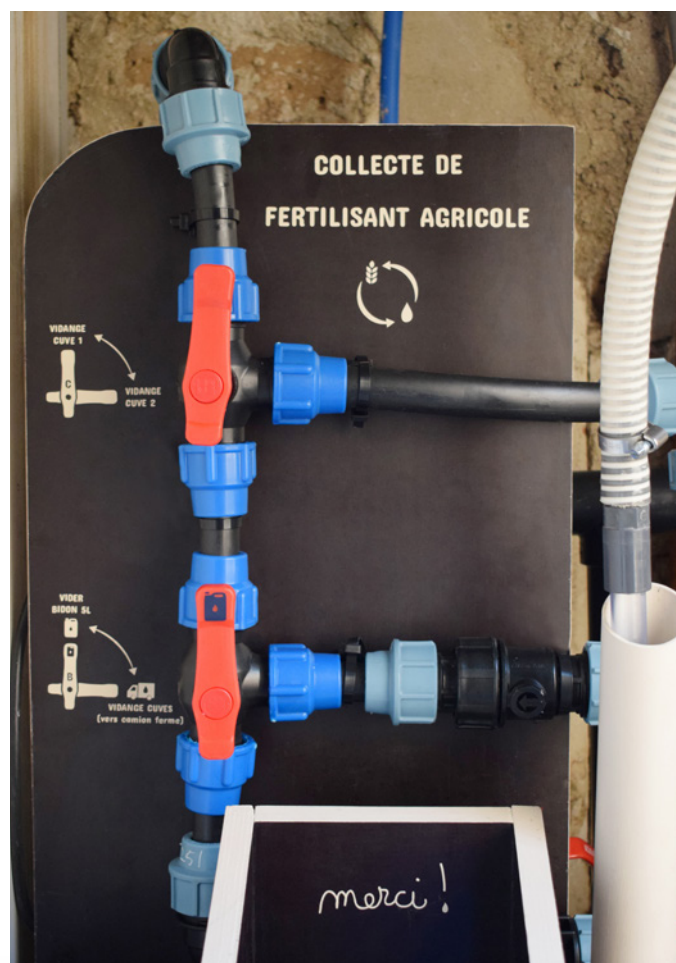
Interface d'utilisation de la station de transvasement. Les vannes (en rouge) sont à manipuler uniquement lors de la vidange, par le personnel de la ferme.
