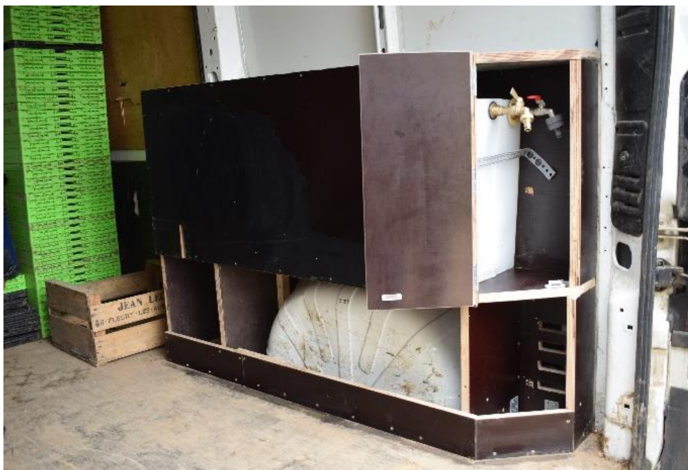
Figure 62 : Installation de la cuve d'urine dans le camion de la ferme partenaire du projet, protégée d'un caisson.
