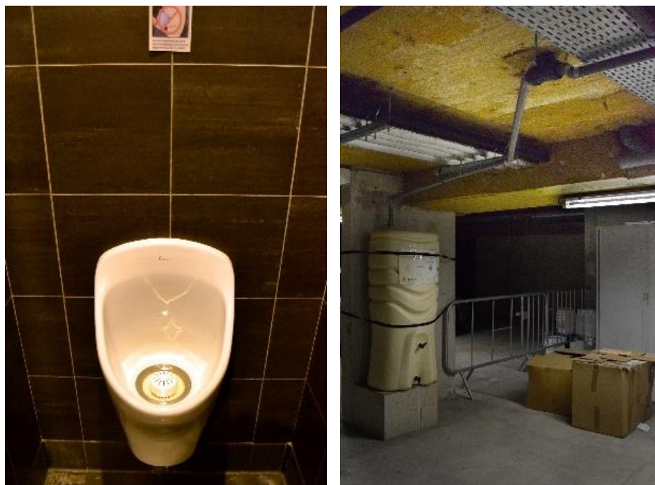
Figure 8 : Urinoir masculin sans eau (à gauche) relié à une cuve de collecte d'urine au sous-sol (à droite).
