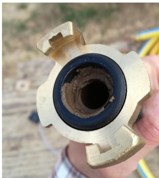
Figure 91 : Dépôts de « boues » par précipitation de l'urine mélangée à l'eau d'irrigation.
