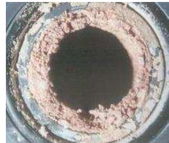
Figure 9 : Tuyau bouché par la struvite (Eawag 2007)
