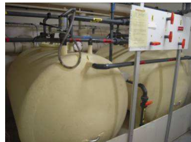
Figure 15 : Cuves de stockage de l'urine décontaminée (crédit personnel)
