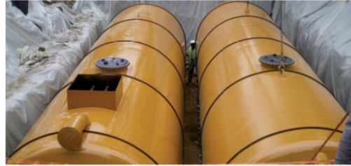
Cuve de réutilisation des eaux pluviales du Parc du Quartier des Bords de Seine à Asnières-sur-Seine
