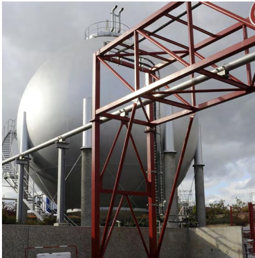
Réservoir à biogaz (STEU SIAAP Seine amont)
